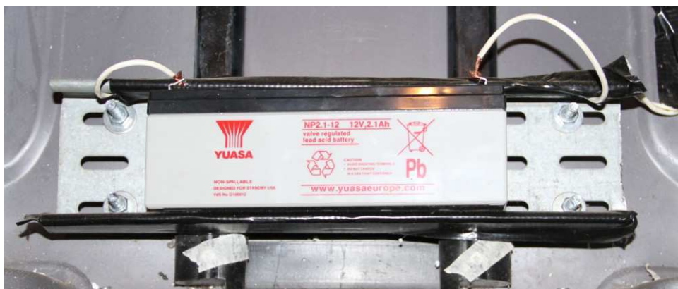
La batterie YUASA NP2-1-12 12V /2,1 Ah soit 2,5 Ah. A 2,16 W pour les deux ventilateurs, l'autonomie théorique est de 11,6 h.
